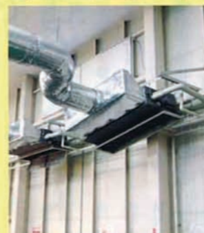
大型のダクトが激しい揺れによってずれている
